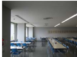
南面窓際の蛍光灯の間引き
