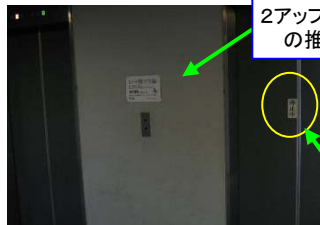
エレベータ3基のうち1基は朝以外の運転を停止
